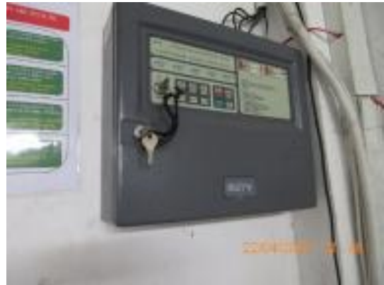
18. Fire alarm center.JPG
